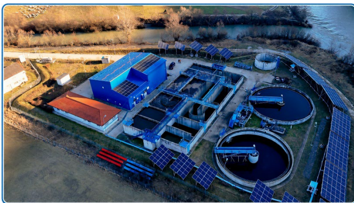
Fig. 62. – Sistem fotovoltaic pentru autoconsum într-o stație de epurare
